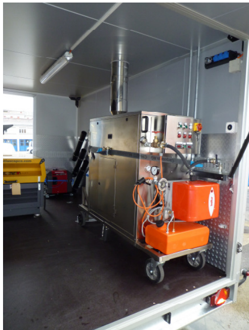
Der Dampf-Erzeuger mobil eingebaut...
